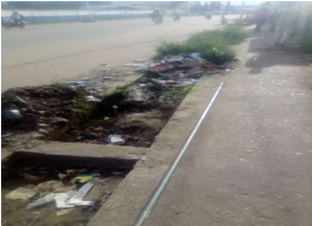
Figure 1: conduite d'eau bouchée
